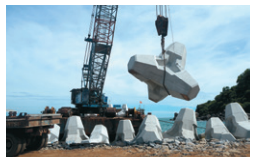
ブロック据付作業 チャンマイ港 / Constructing Blocks at Chan May Port
