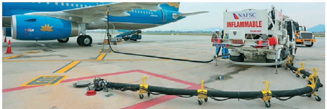
ハイドラント給油設備 / Hydrant-type refueling equipment
