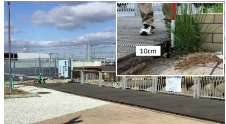
福島県沖地震により、遊歩道部が沈下
