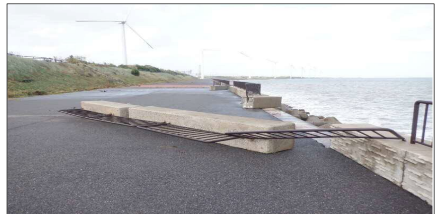
台風14号により、転落防止柵が倒壊
