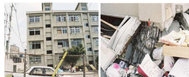
R C造・ラーメン構造(5階建)地震により1階部分が圧壊
