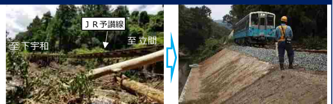
被災直後 復旧後
