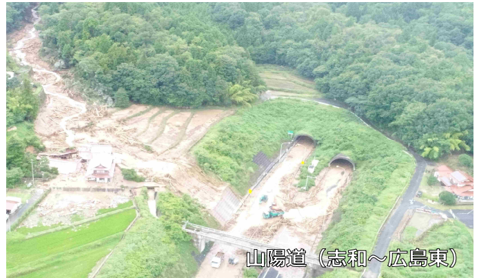
<山陽道の被災状況>
