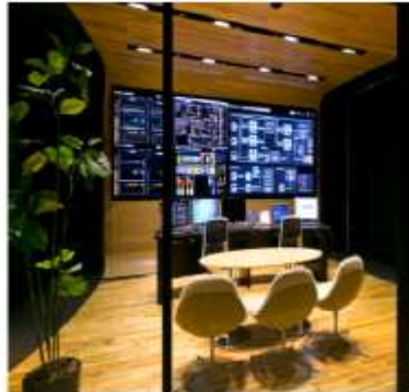
エネルギー管理システム
