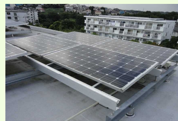
太陽光発電関連設備の設置
