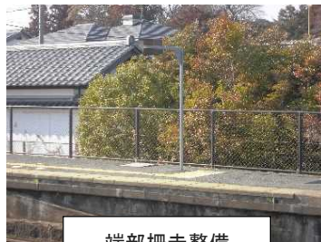
端部柵未整備
