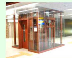
エレベーター
