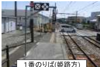
1番のりば(姫路方) フェンス未整備
