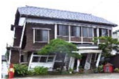
残留変形が大きい木造建築物
