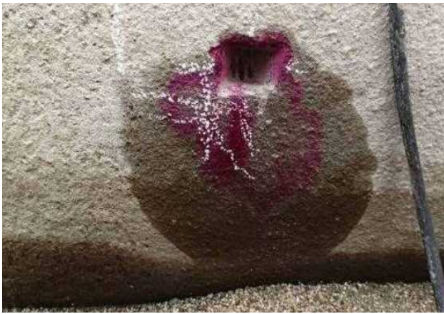
写真-3 チッピング箇所での地下水の浸出
