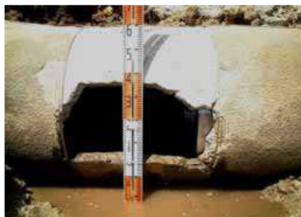
写真-1 PC管の劣化に伴う出水（他地区）
