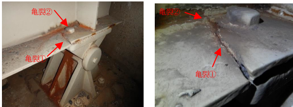
写真-7 亀裂①、②の状況
