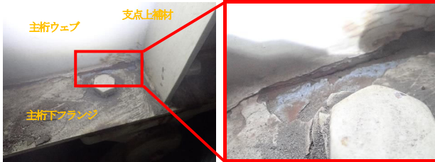
写真-5 主桁亀裂：支承中心より胸壁側
