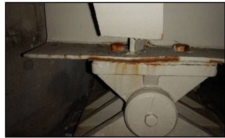
写真-10 ソールプレート未設置状況
