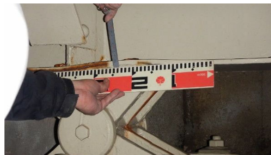
写真-4 下フランジの変形
