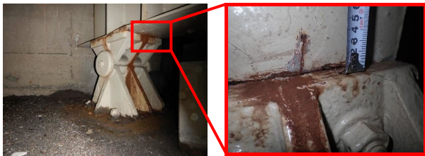
写真-6 主桁亀裂：下フランジ下面
