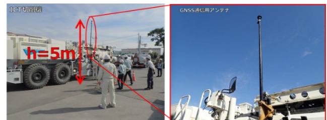
図-1 ICT切削機に付属する高さ5mのアンテナ
