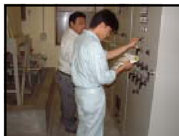
非常電源の立ち上げ状況
