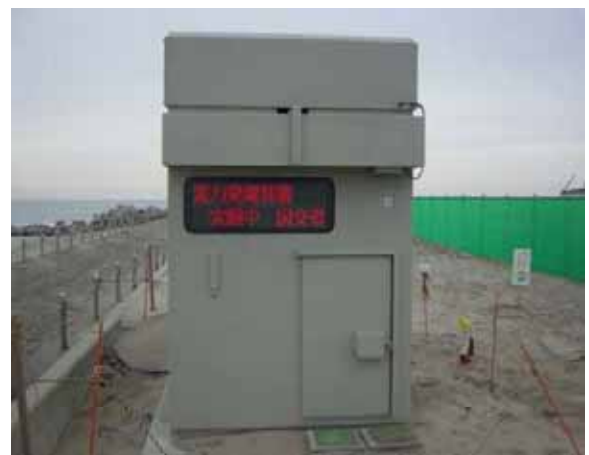
写真-4 陸上制御ボックス
