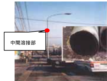
写真1. 中間溶接部の腐食状況
