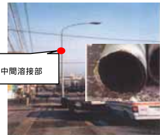
写真1. 中間溶接部の腐食状況
