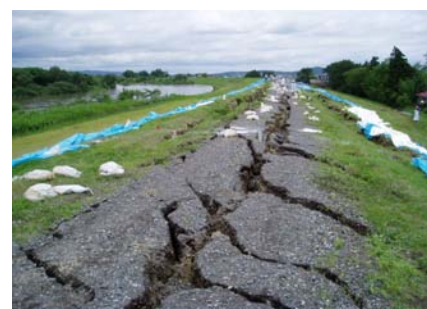
写真-2 鳴瀬川堤防(南郷町二郷)被災状況
