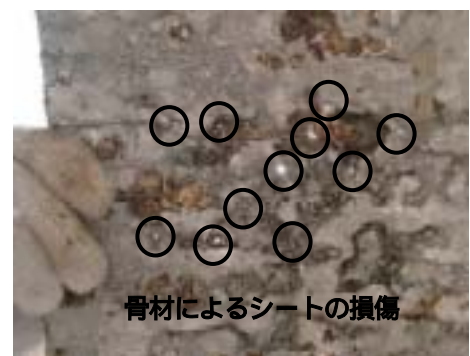
写真4 床版防水Bの貫通孔
