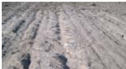
写真1 模擬床版の凹凸状態
