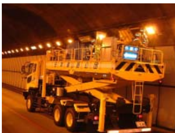
写真 - 1（トンネル照明灯具洗淨装置全景）
