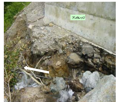
写真－4 アンカレッジ 前面の洗掘状況
