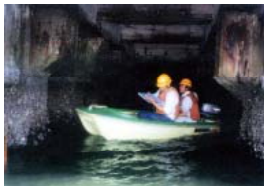
写真-1 栈橋下劣化状況のスケッチ
