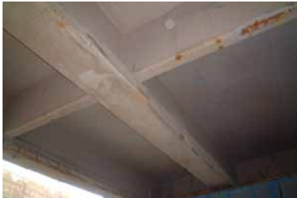
写真-2 主桁の劣化状況
