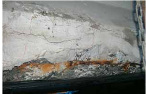
写真-3 断面修復部の再劣化状況
