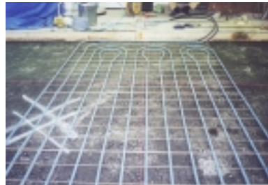
写真-2 温水パイプ
