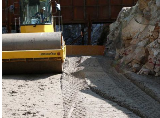
写真-1：振動ローラによる締固面の乱れ
