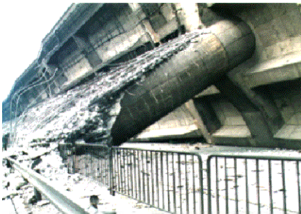
・兵庫県南部地震の被害例
