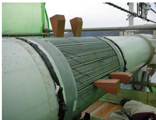
写真-3 素線調査状況
