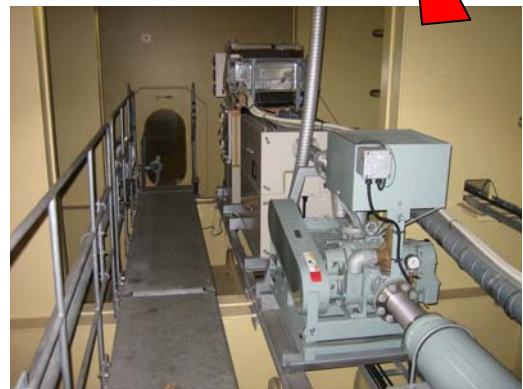
写真-2 送気設備設置状況
