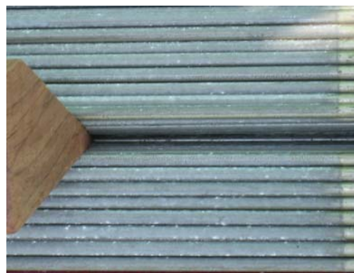
写真-4 内層素線の状況
