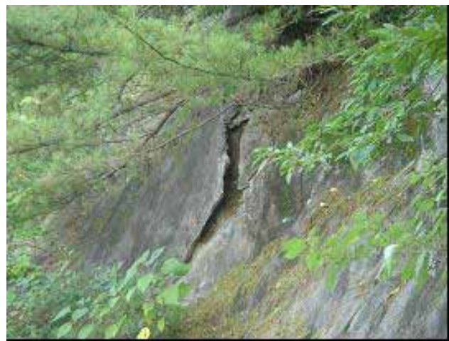
写真-2 モルタル損傷状況
