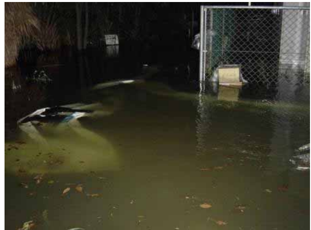
写真 3.4 屋外用受変電設備周辺
