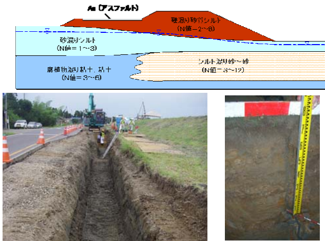
図-5 町軽井地区の堤防横断地質図とクラックの開削断面調査
