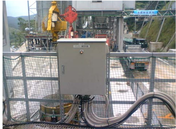
【写真10：コンクリート配合信号盤】
