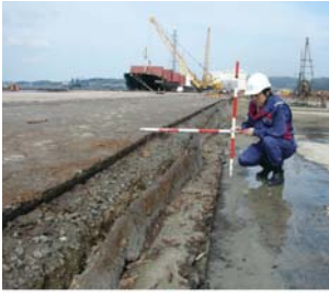
図-3 背後地に生じた段差
