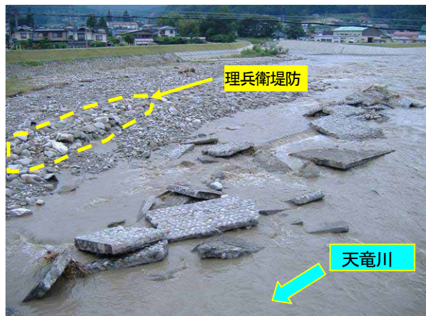
写真2 被災した旧堤護岸と理兵衛堤防
