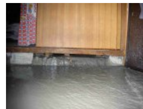
写真-1.2.3 住宅床下の噴出
