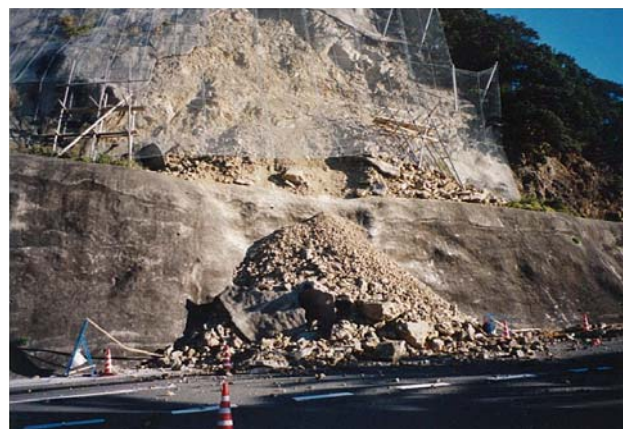
図-1 紀南河川国道事務所管内における法面崩壊事例
