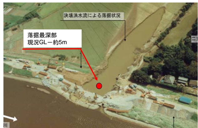
写真-4 堤防決壊後の落掘状況 昭和56年小貝川高須地先
