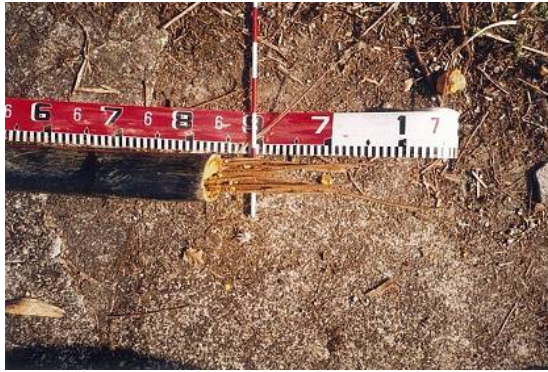
写真4 破断部 (PC鋼より線: 4-1孔)
