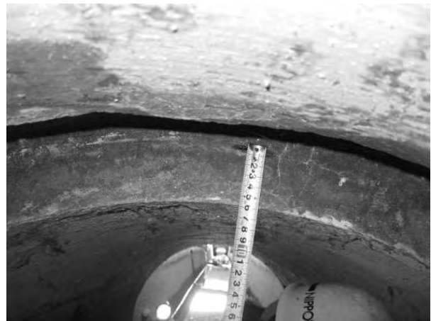
図-3 パイプカルバートの継ぎ手部段差
