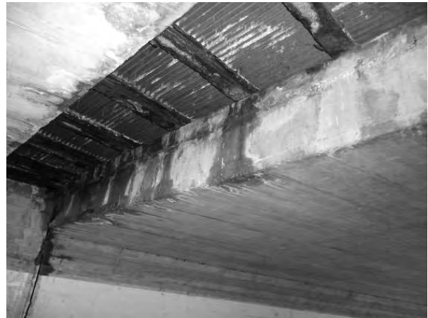
図-2 頂版部の鋼材腐食事例
