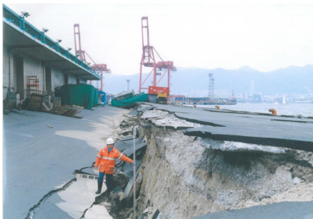
写真-1 ケーソン式岸壁の地震被害例
