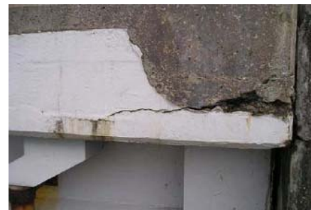
写真-2 下部工塩害状況
