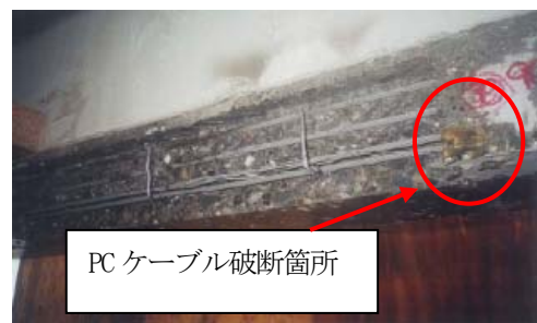
写真-3 上部工塩害状況
