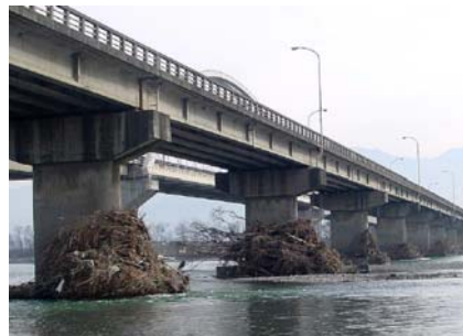
図-4 洪水後、橋脚に引っ掛かる流木
