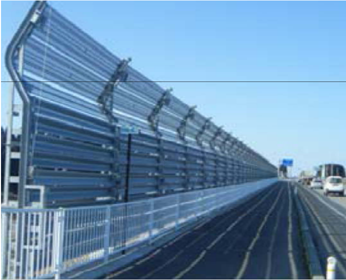
防雪柵存置の状況
