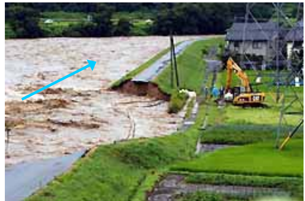
写真-1 箕輪町松島地区堤防決壊状況
