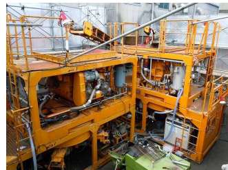
写真-2 流動化砂製造プラント
