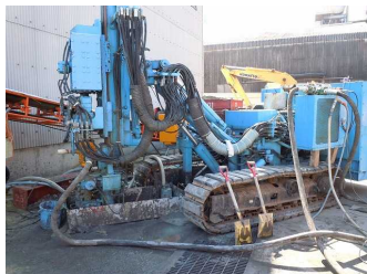
写真-4 施工状況 (近景)
