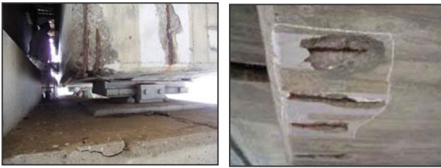
写真3-1 主桁端部下面の鉄筋腐食による剥離・鉄筋露出
