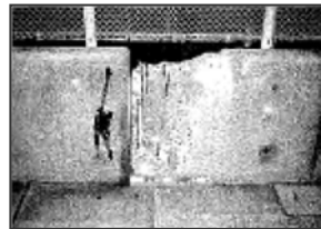
写真3-2 目地遊間が無くなり中央ヒンジ部壁高欄の破損 (1993年5月点検時の状況)
