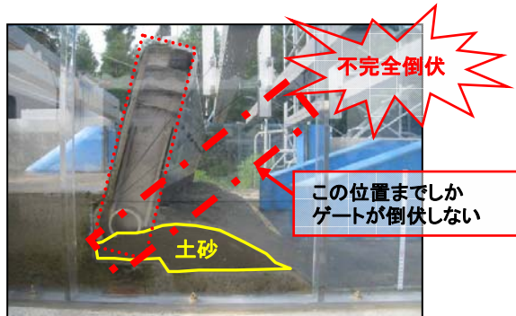
写真-4 土砂堆積によるゲート不完全倒伏
