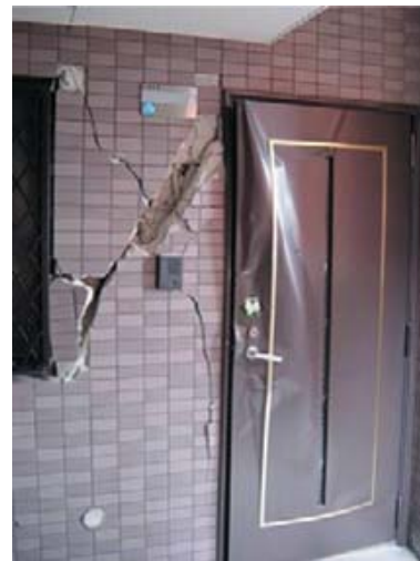
写真2 平成17年福岡県西方沖地震における共同住宅の廊下側非構造壁のひびわれ損傷
