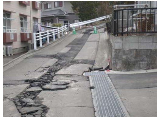
図-5 図-3中 Point2 (緑ヶ丘4丁目)における被害状況
