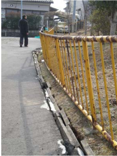
図-4 図-3中 Point1 (緑ヶ丘3丁目)における被害状況
