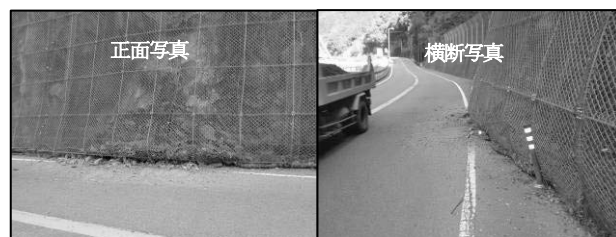
写真-6 法面崩壊前兆写真
