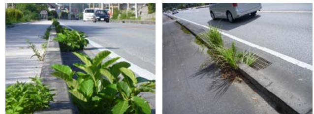
(a) グレーチング部 (b) 堆砂部 写真-1 清掃の不備による雑草の事例
