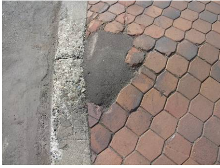
写真-13 除雪による舗装の損傷 (北海道)
