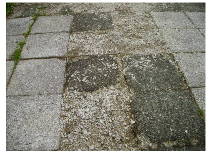
写真-2 劣化したブロック舗装 (北海道)
