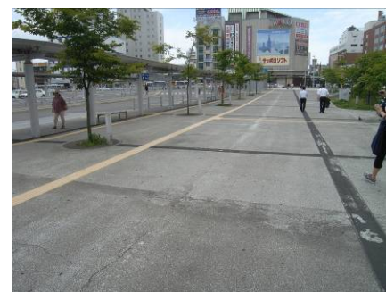
写真-11 施工管理、品質管理の不徹底から 表面が劣化したと考えられる舗装(北海道)
