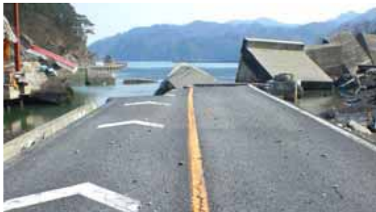
図-4 国道45号釜石市両石地区道路流失
