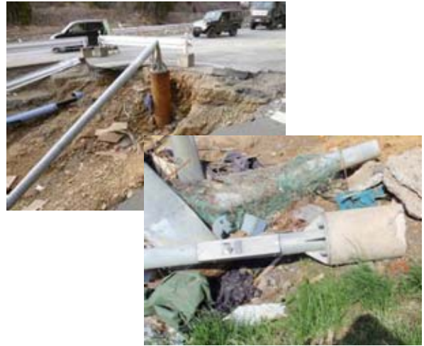
写真-7 道路照明灯倒壊状況
