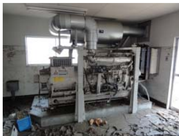
写真-15 東北技術事務所 電気室 (発動発電機)
