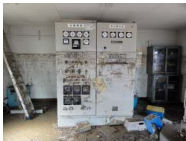
写真-14 東北技術事務所 電気室 (発電機盤及び始動用蓄電池盤)
