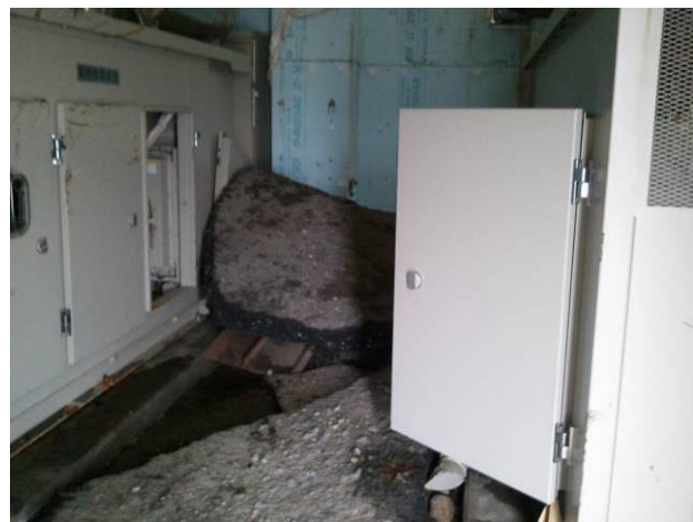
写真-13 月浜第一水門 電気室内部 （アスファルト塊が電気室内に流された）
