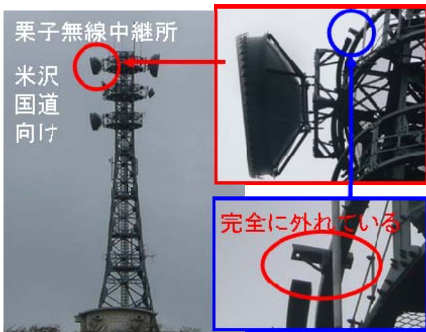
写真-1 空中線架台状況
