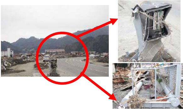
支柱が折れている状況
