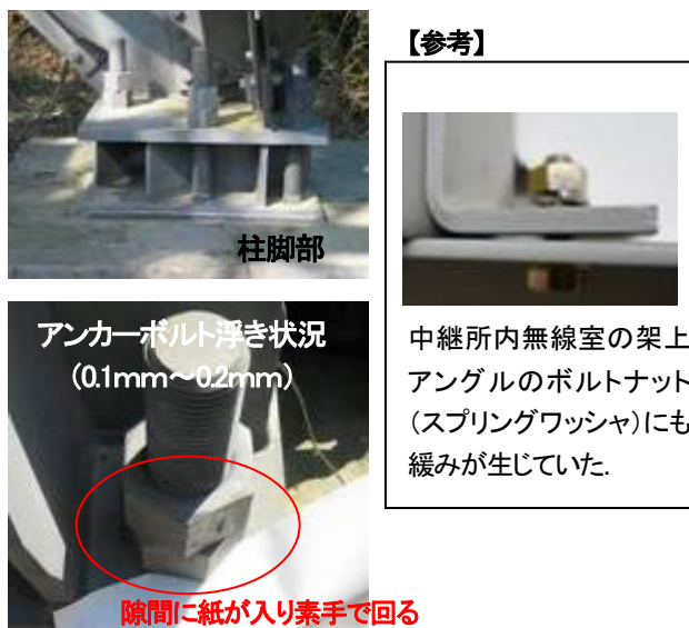
写真-2 鉄塔アンカーボルトの状況 籠岳無線中継所（宮城県涌谷町）
