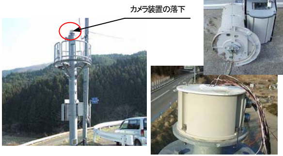
写真-4 CCTVカメラ脱落状況
