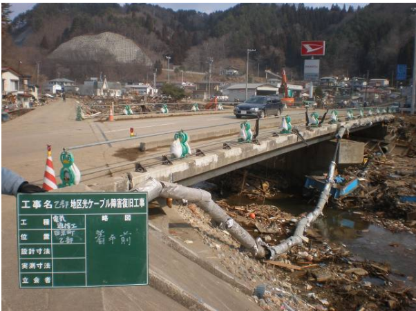
写真-12 情報BOX橋梁部被災状況 (岩手県宮古市)
