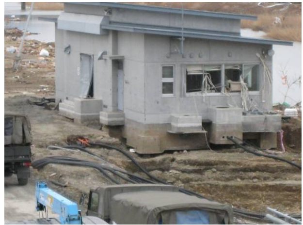
写真-12 月浜第一水門 電気室外観
